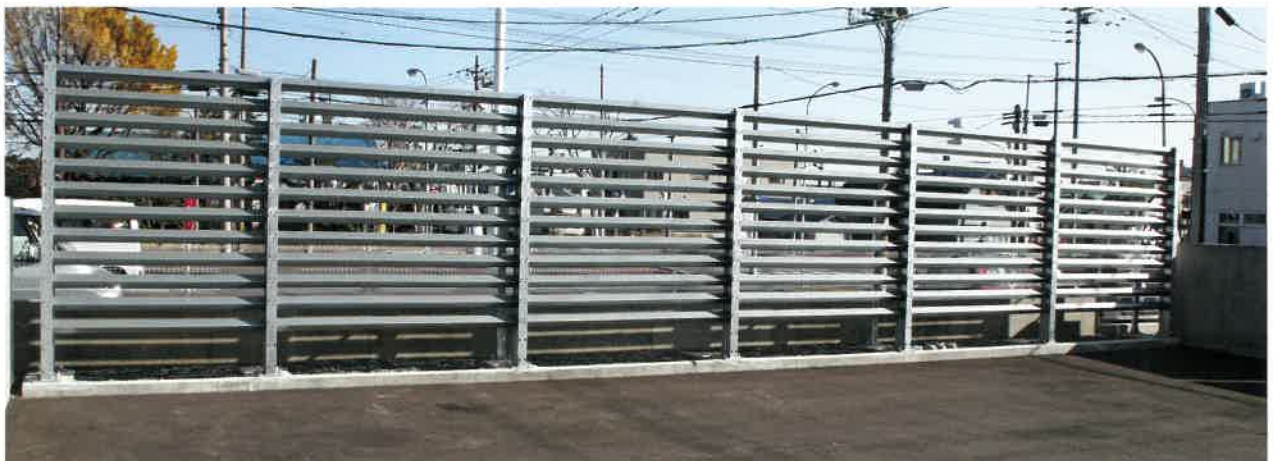
駐車場除雪堆積用フェンス
